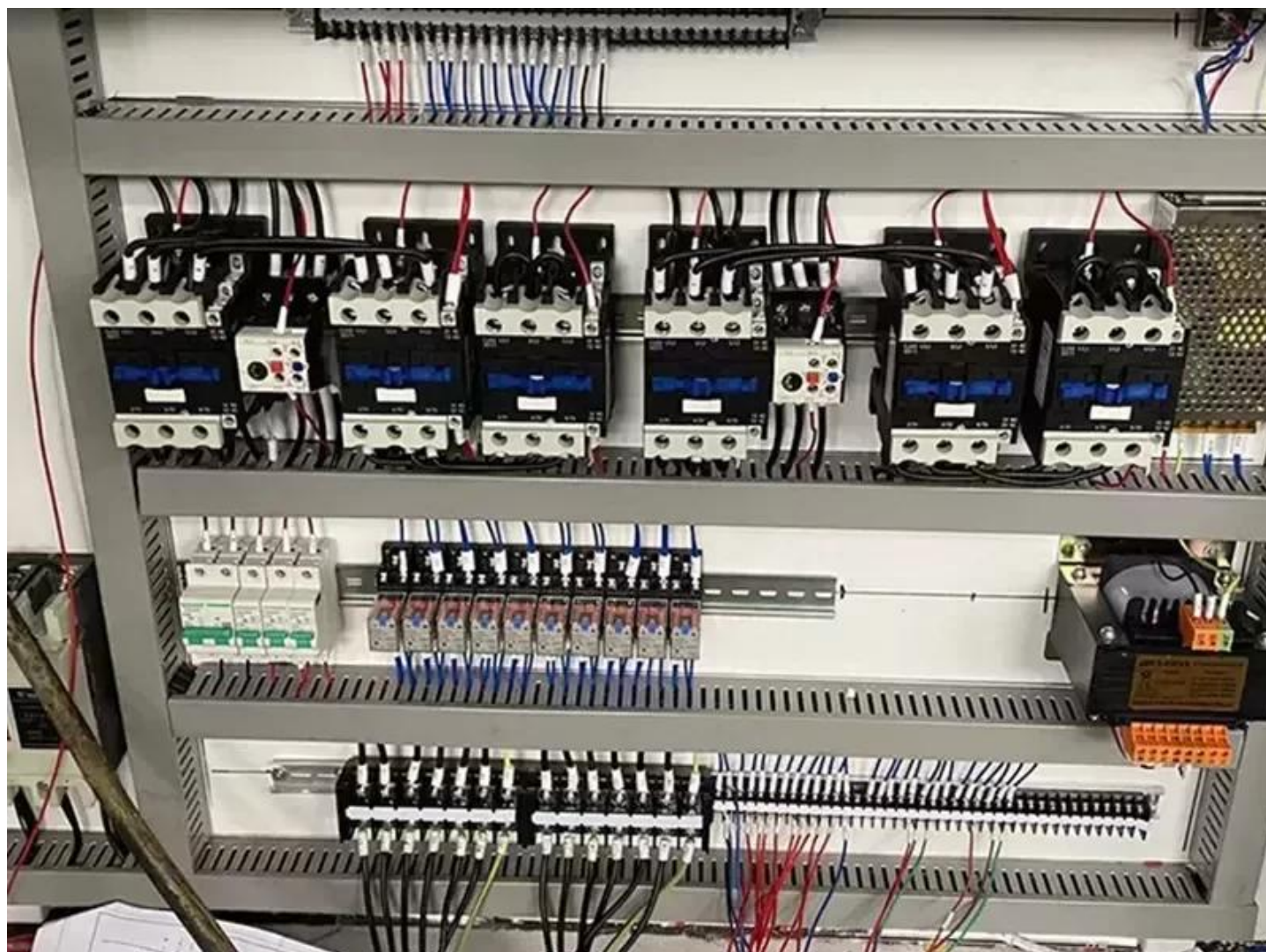
Schaltschrank und Steuerungssystem
